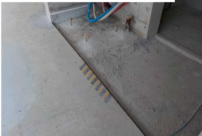
【段差部・開口部の見える化-トラマーク設置】
